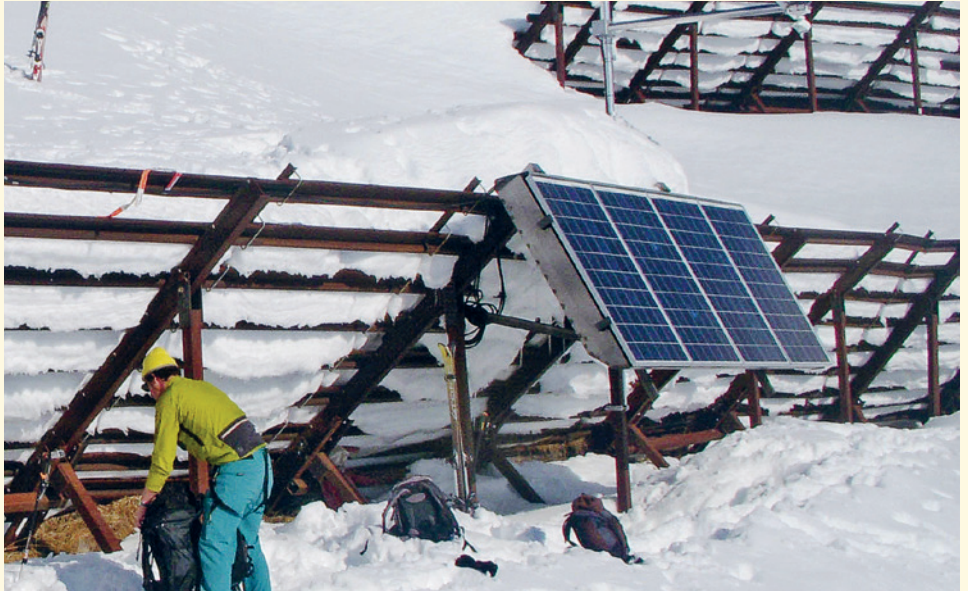
Eine von vier Versuchs-Solaranlagen auf Lawinenverbauungen in St. Antönien (GR). Auf dem Stützrost hinter den Solarmodulen hat sich zusätzlich Schnee abgelagert – ein potenzielles Sicherheitsrisiko.
