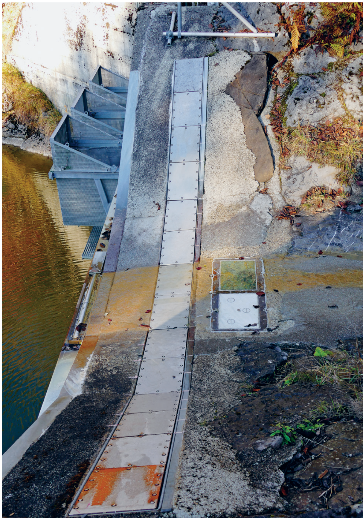
Geofone, die sich auf der Unterseite dieses Stahlplattenbandes befinden, zeichnen Erschütterungen auf und messen so den Geschiebetransport kontinuierlich. Die drei metallenen Fangkörbe werden bei starkem Abfluss automatisch nacheinander in den Abflussstrahl gezogen.
